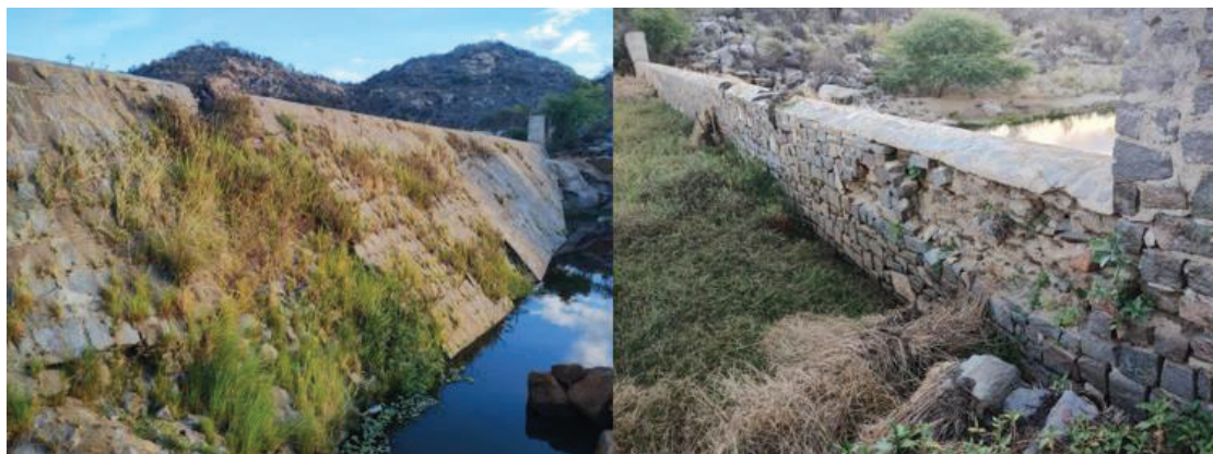
Poço de Fora (BA) – Deterioração dos paramentos montante e jusante da barragem, com perda parcial do revestimento em pedra argamassada (Ação Popular, 2023).
